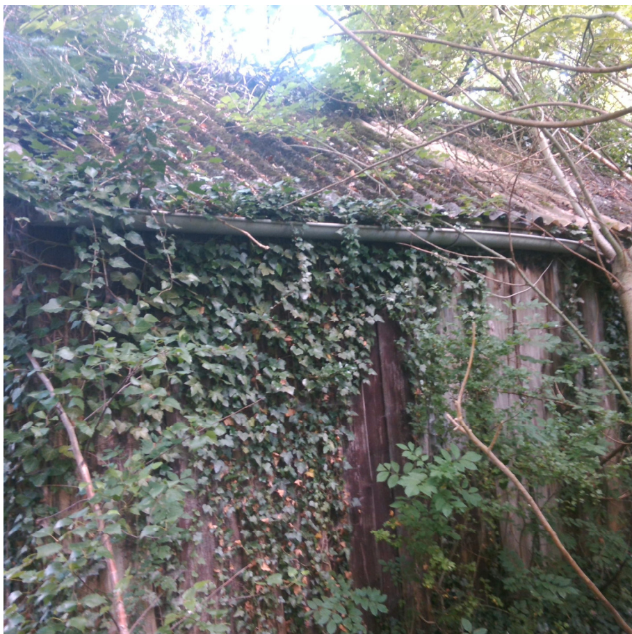
Foto 11 (schuurtje met asbestverdachte golfplaten)
