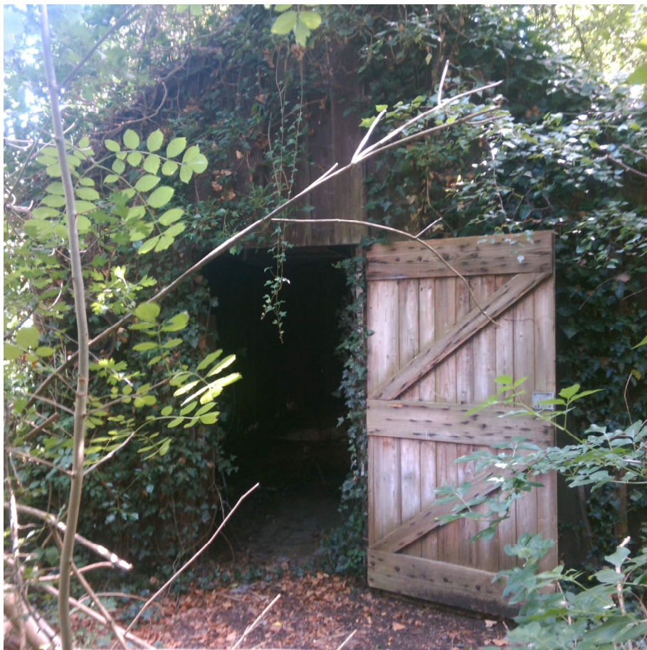
Foto 10 (schuurtje met asbestverdachte golfplaten)
