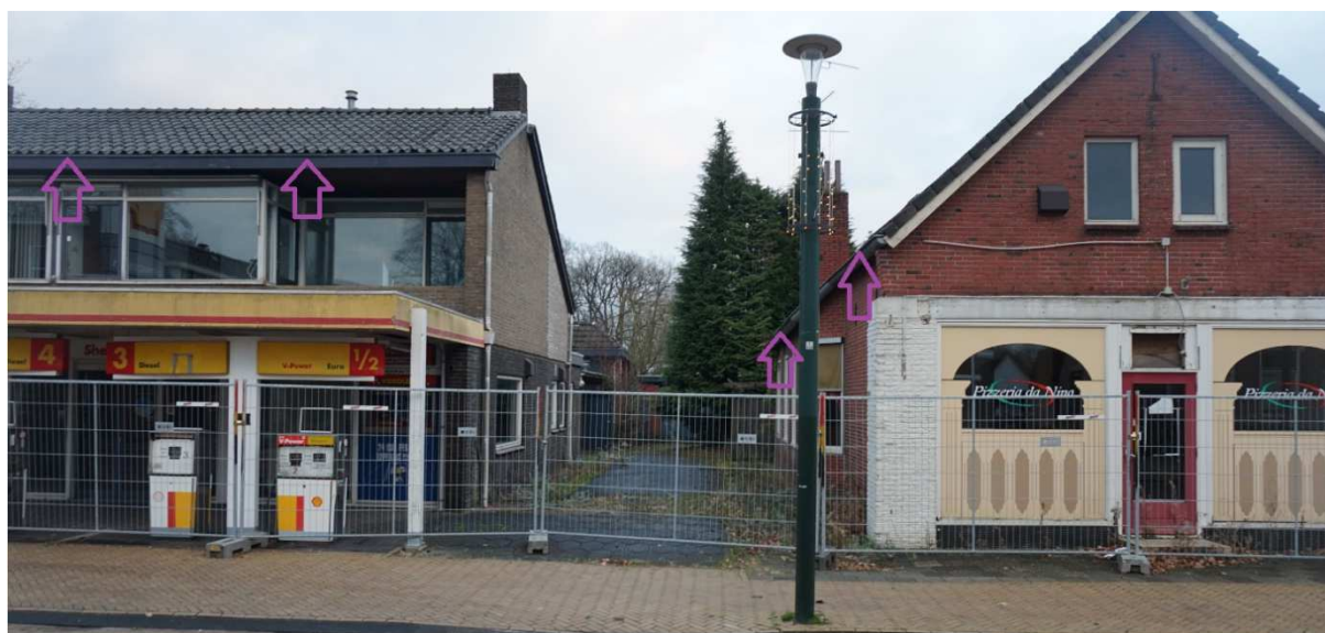
Figuur 5.1. Enkele locaties waar huismussen via de dakgoten onder de dakbedekking kunnen komen.
