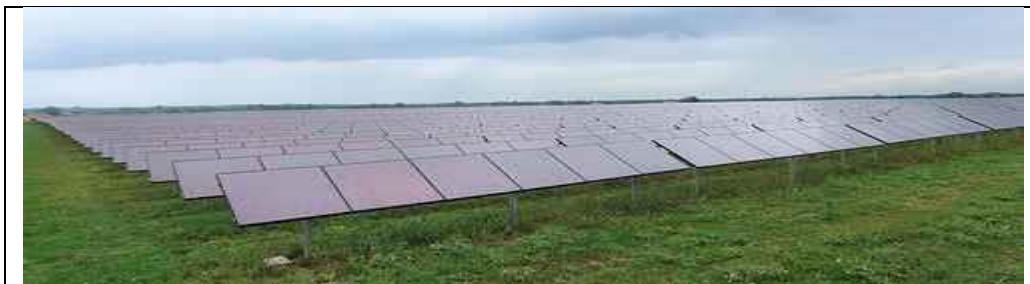
Figuur 5. Voorbeeld van zonne-energie park (bron: www.duurzameenergiethuis.nl )
