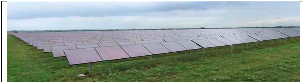
Figuur 13. Voorbeeld van zonne-energie park (bron: www.duurzameenergiethuis.nl )
