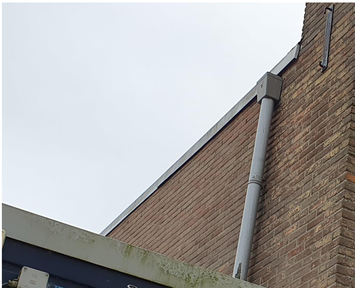
Foto 1: Open stootvoegen aan noordoostzijde van het gebouw
