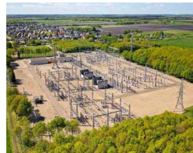
▲ Fig. 2 Voorbeeld hoogspanningsstation. Zijerveen, Assen. Bron: TenneT.
