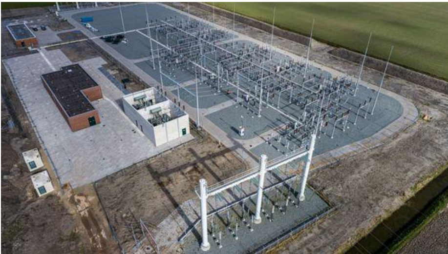
Indruk van de schaal en maat van een 150 KV station
