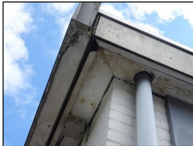
Figuur 23. Gaten en opening in de daklijst van de winkel.
