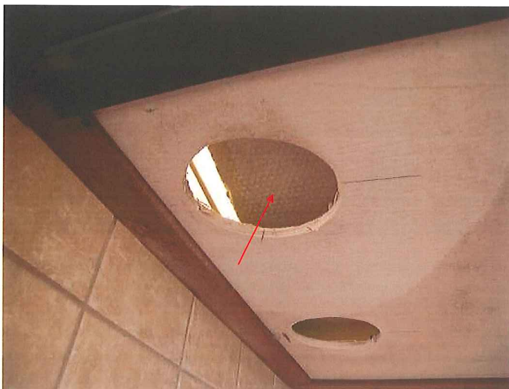
Foto 2 Niet asbesthoudende plafondplaten bovenzijde cv-ruimte toiletgebouw 2 (M02)
