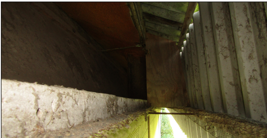
Figuur: aan de zijkanten van de achterste stal is een ventilatieschacht aanwezig. Op bepaalde plaatsen is het kippengaas kapot en is de ruimte toegankelijk voor bijvoorbeeld kerkuil of de steenmarter.
