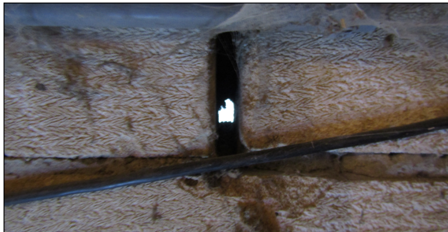
Figuur: in deze spleet in de achterste schuur is zichtbaar dat er geen spouwmuur aanwezig is.
