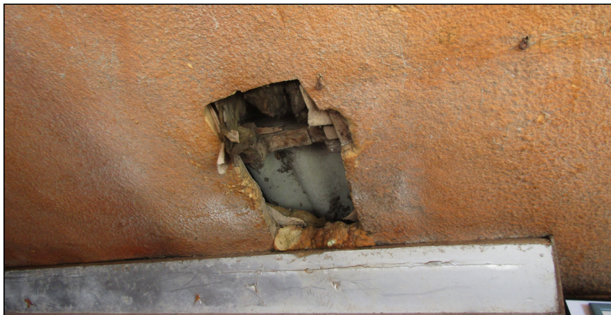
Figuur: via dit gat in het plafond van de achterste stal, is zichtbaar dat er ruimte zit tussen het isolatiemateriaal en de golfplaten. Vogels en steenmarter kunnen van deze ruimte gebruik maken.
