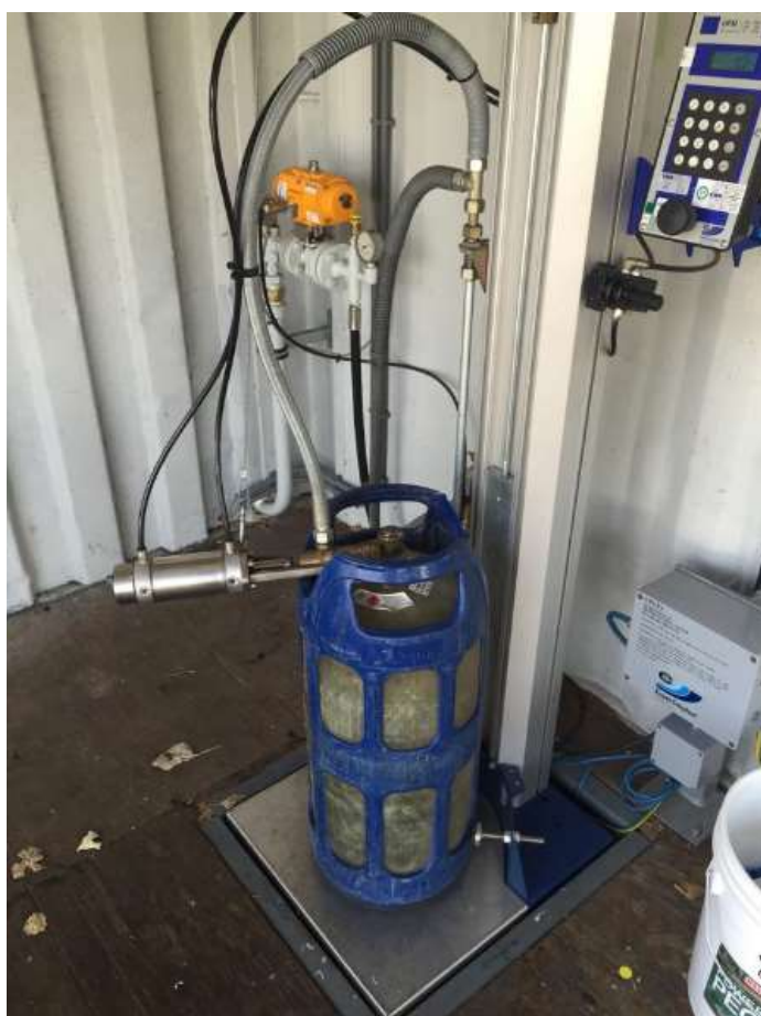
Foto 9: Vulinstallatie geplaatst in container.
