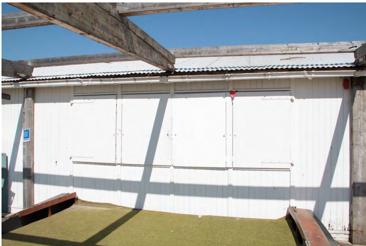
Figuur 9: Bedrijfsloods van Sfeer strand met ruimte onder dakplaten.
