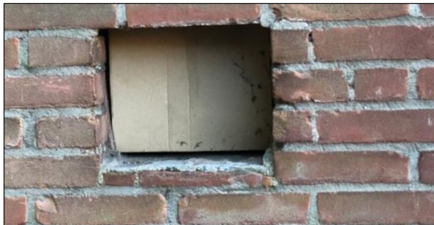
Figuur: aangeleverde foto (22 juli 2020) van het gat op de noordgevel. Deze is aan de binnenzijde afgedicht waardoor de spouw niet toegankelijk is voor bijvoorbeeld steenmarter. Zie ook foto rechts.
