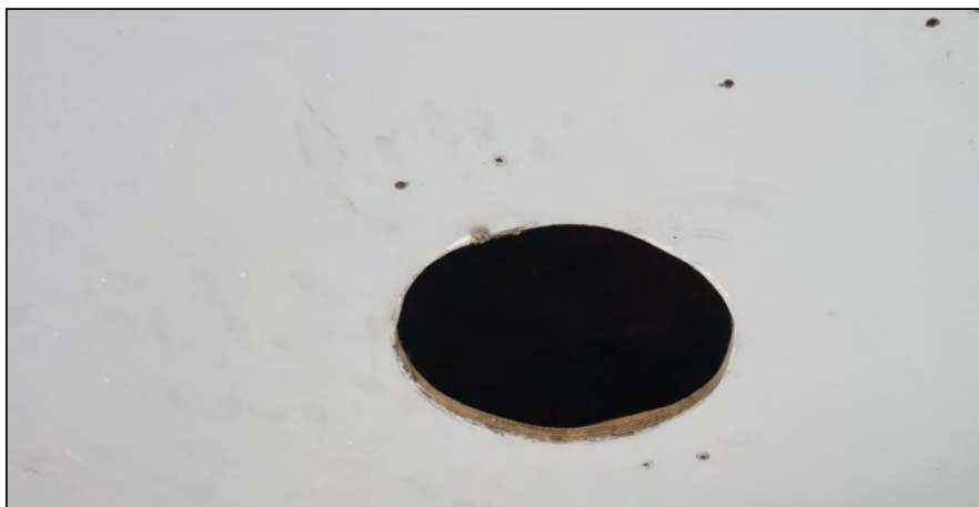
Figuur: onder een luifel op de westgevel is een groot gat aanwezig. Deze opening is ongeschikt voor huismus omdat de kans van predatie te groot is.
