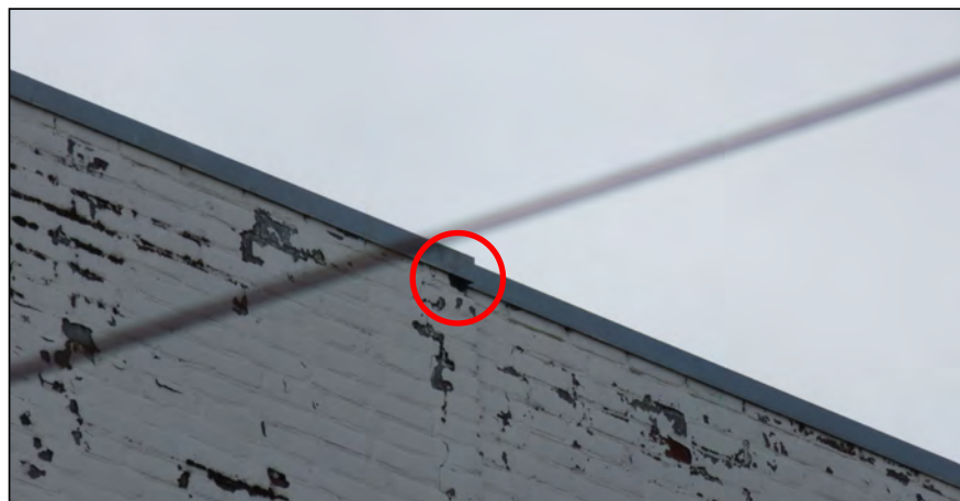
Figuur: de opbouw op het dak heeft openingen onder de dakrand (zie cirkel). Hier kunnen vleermuizen invliegen en verblijfplaatsen hebben. De opening is groot genoeg voor kraamverblijfplaatsen ( >1,5 cm).
