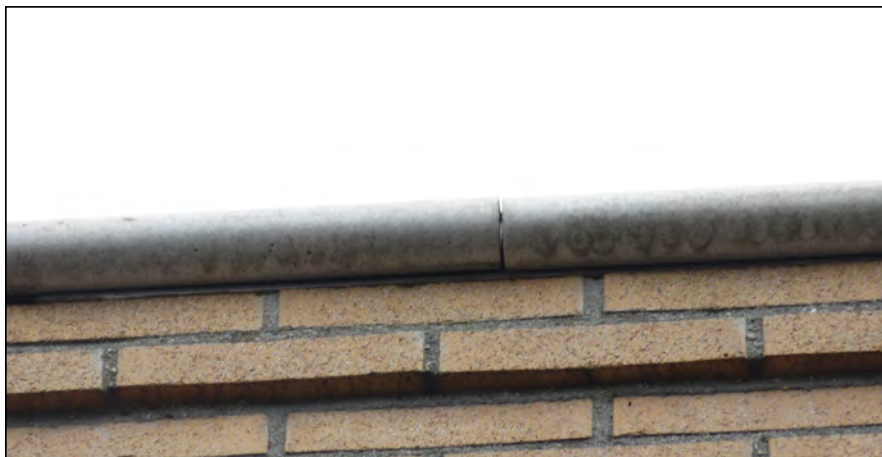
Figuur: onder de dakrand van de zuidwestgevel is geen ruimte aanwezig.
