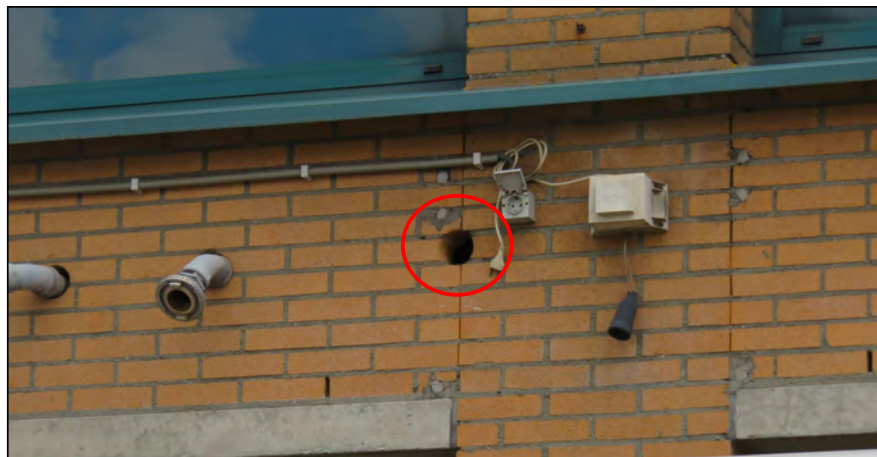
Figuur: op de westgevel is een opening in de muur aanwezig. Deze is ongeschikt voor huismus (te groot) en steenmarter (te hoog en ontbreken van dekking en foerageergebied).
