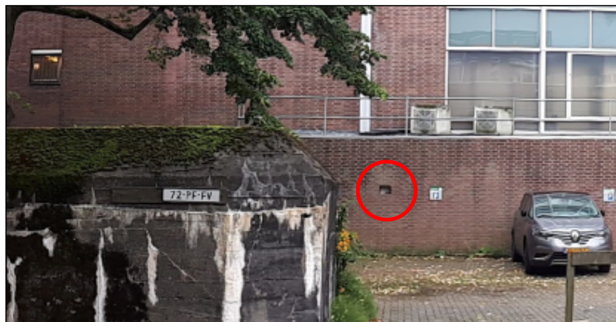
Figuur: aangeleverde foto (5 september 2019) van de noordgevel (kijkrichting zuid). Er lijkt een opening aanwezig in de bakstenen muur. Op 22 juli 2020 is er een nieuwe foto aangeleverd van dit gat (zie linksonder).
