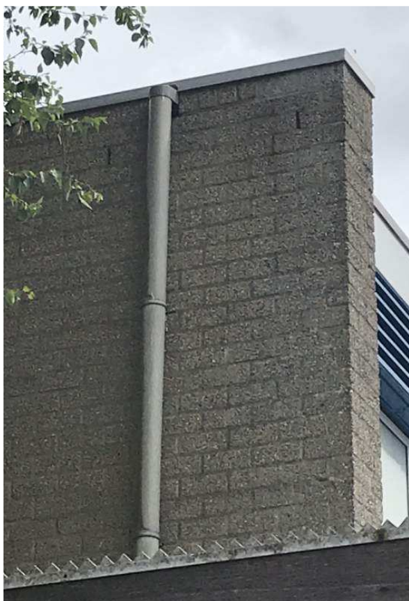
Figuur 12. Detail van de noordkant van het gymlokaal, met open stootvoegen en een invliegmogelijkheid voor vleermuizen bij de regenpijp.
