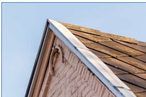
Figuur 07: opening tussen dak daktrim en dak
