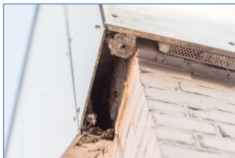
Figuur 06: opening tussen dak boeiboord en muur
