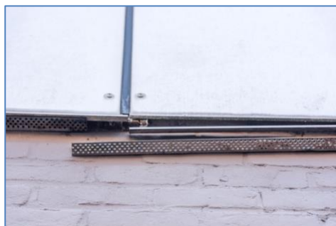
Figuur 08: openingen tussen betimmering en muur
