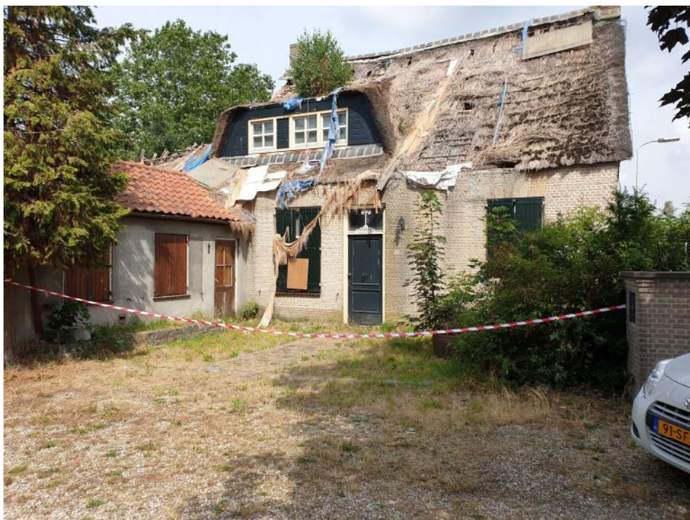
Figuur 10 - De voormalige boerderij Passenberg 18 (foto: juli 2019); de boerderij is de laatste jaren kwalitatief zeer snel achteruit gegaan; het rieten dak vertoont grote gaten en delen zijn ingestort; in de dakkapel groeit zelfs een boom; blik vanuit het zuidoosten; het pand is inmiddels afgebroken
