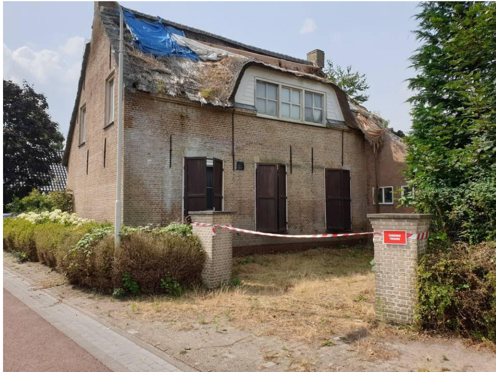
Figuur 9 - Beeld Passenberg 18 (foto: juli 2019); blik vanuit het noordoosten; het dak van de boerderij is in zeer slechte staat; daardoor treden verzakkingen en breuken op
