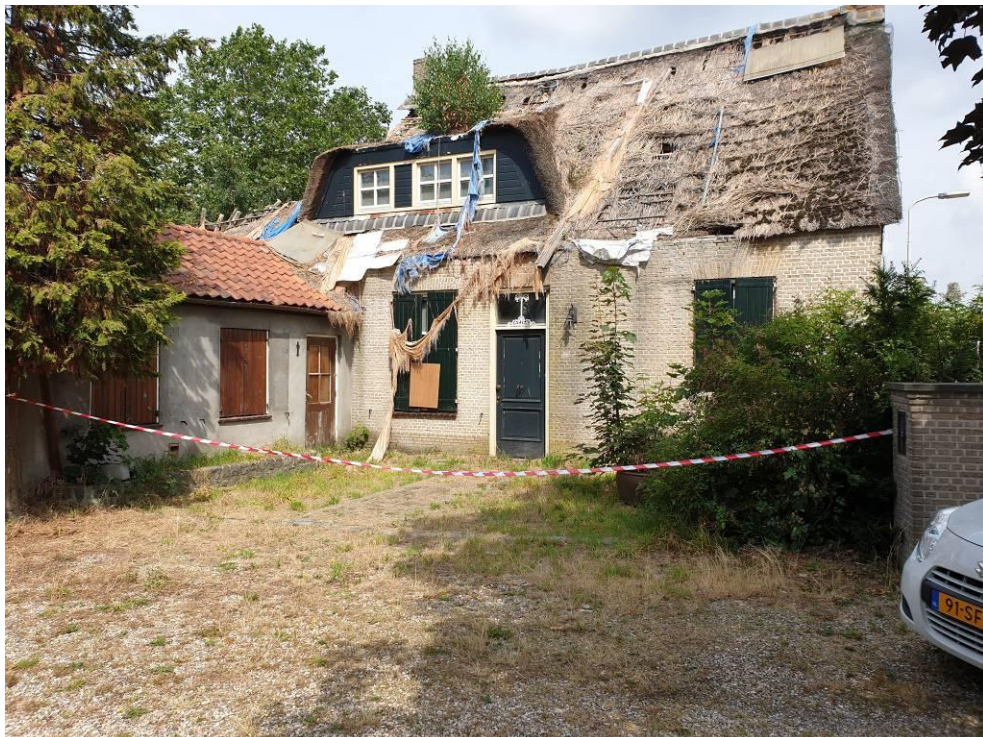
Figuur 10 - De voormalige boerderij Passenberg 18 (foto: juli 2019); de boerderij is de laatste jaren kwalitatief zeer snel achteruit gegaan; het rieten dak vertoont grote gaten en delen zijn ingestort; in de dakkapel groeit zelfs een boom; blik vanuit het zuidoosten.
