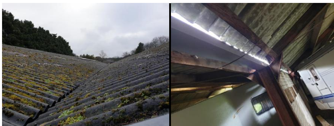
Figuur 6. Opening in het dak. Mogelijke invliegopening.
