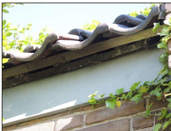
Figuur 13. Openingen onder dakpannen welke door vleermuizen gebruikt kunnen worden.
