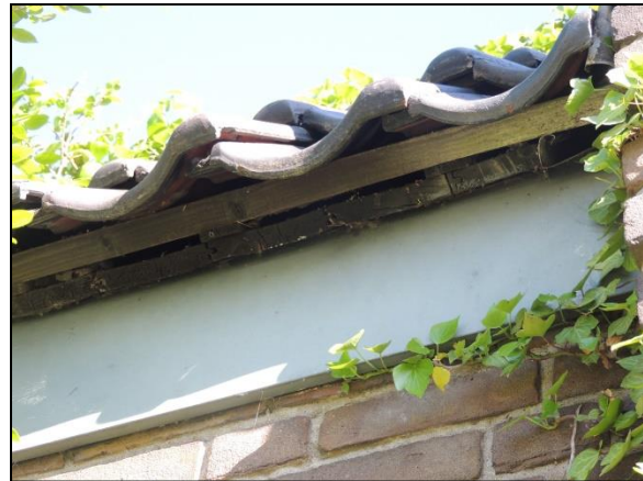
Figuur 13. Openingen onder dakpannen welke door vleermuizen gebruikt kunnen worden.
