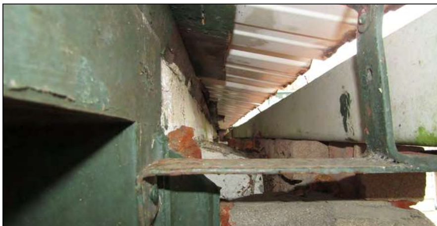
Figuur: achter de dakgoten van het hoofdgebouw zijn nissen aangetroffen waar vogels zonder jaarbond beschermd nest kunnen broeden.
