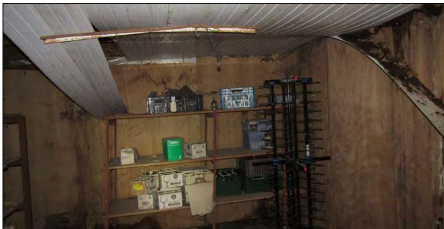
Figuur: in sommige schuren is het dakbeschot deels ingestort. Hierdoor kunnen marters de ruimte onder de dakbedekking bereiken.
