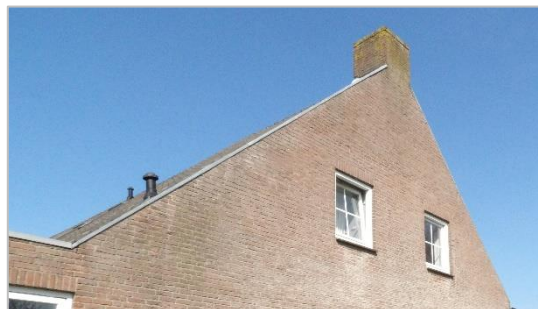
Foto 13: Gevels bezitten geen stootvoegen of kieren/spleten bij dakrand.
