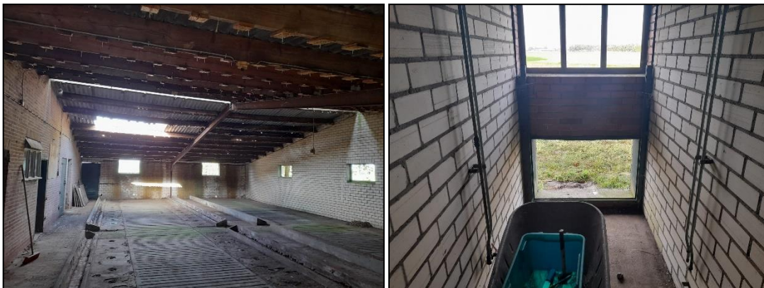
Figuur 6. De noordelijke schuur bevat beschadigingen aan het dak (links) en de ramen (rechts).
