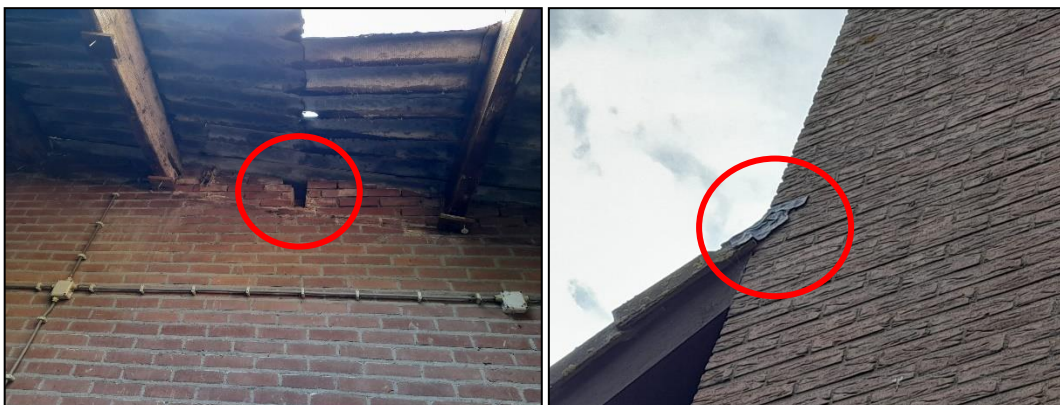
Figuur 7. De beschadigingen aan de noordelijke schuur (links) en de daklijst en loodslab aan de woning (rechts) geven toegang tot de dakpannen.
