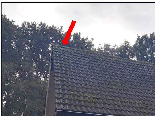
Figuur 9. Het pannendak van de woning bevat slechts één potentiële opening waar het vulsel onder de dakpan is weggefallen.
