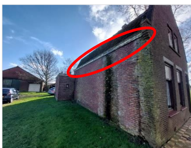
Figuur 4.5 Diverse openingen onder de daklijst.
