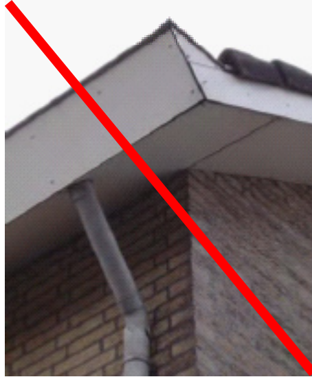
foute-niet passende gootdetaillering
