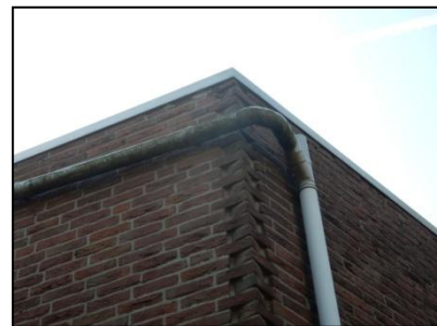
Figuur 5. Open ruimtes tussen dakrandprofiel en de gevel.
