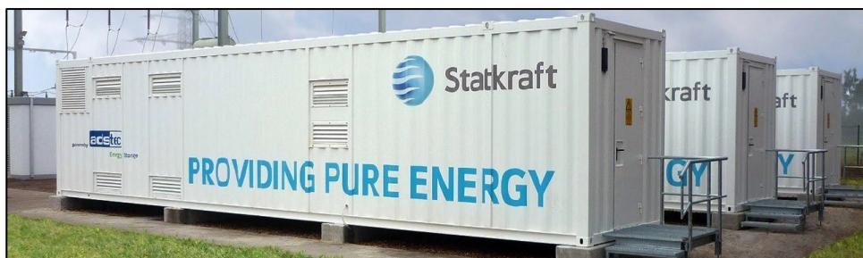
Figuur 18: Energie opslagsysteem gerealiseerd door Statkraft in Duitsland, Dörverden.
