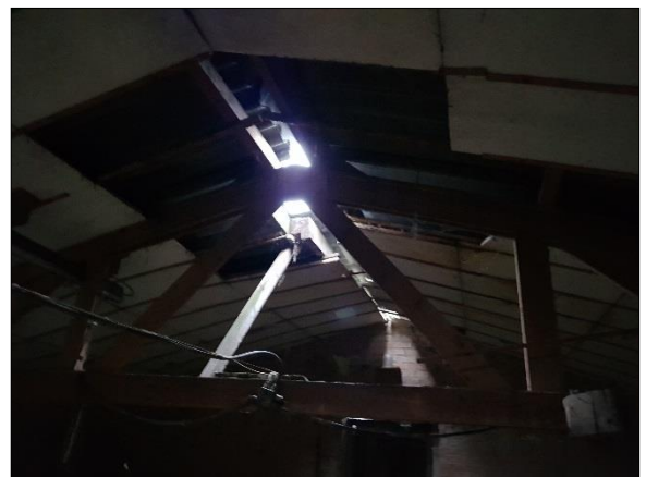
Figuur 8. Staat binnenzijde vervallen stal (plangebied 2)
