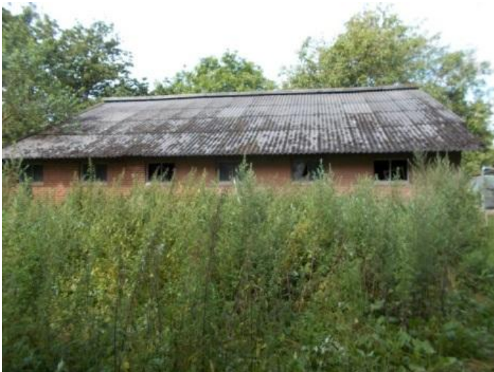
Foto 5: Onderzoekslocatie (oude varkensstal met asbest-dakplaten)
