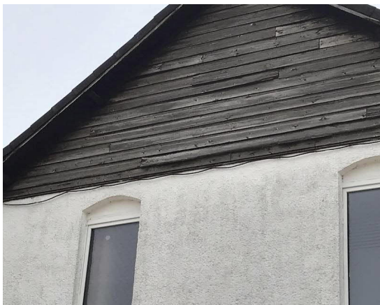
Afbeelding 14. Openingen langs het houtbeschoot van het Chinees restaurant.
