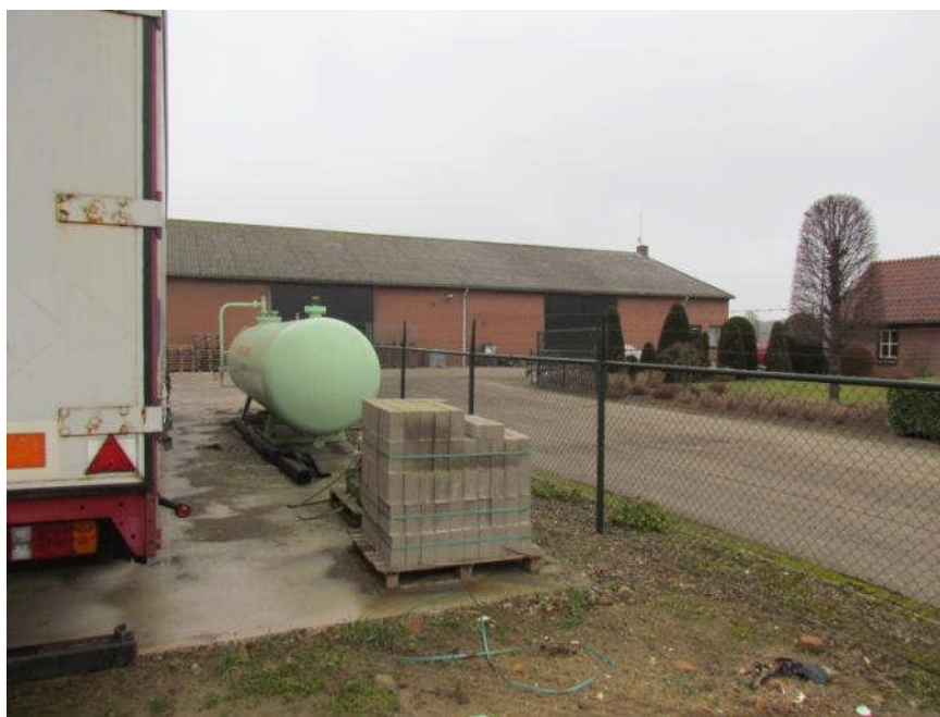
Te verplaatsen gastank
