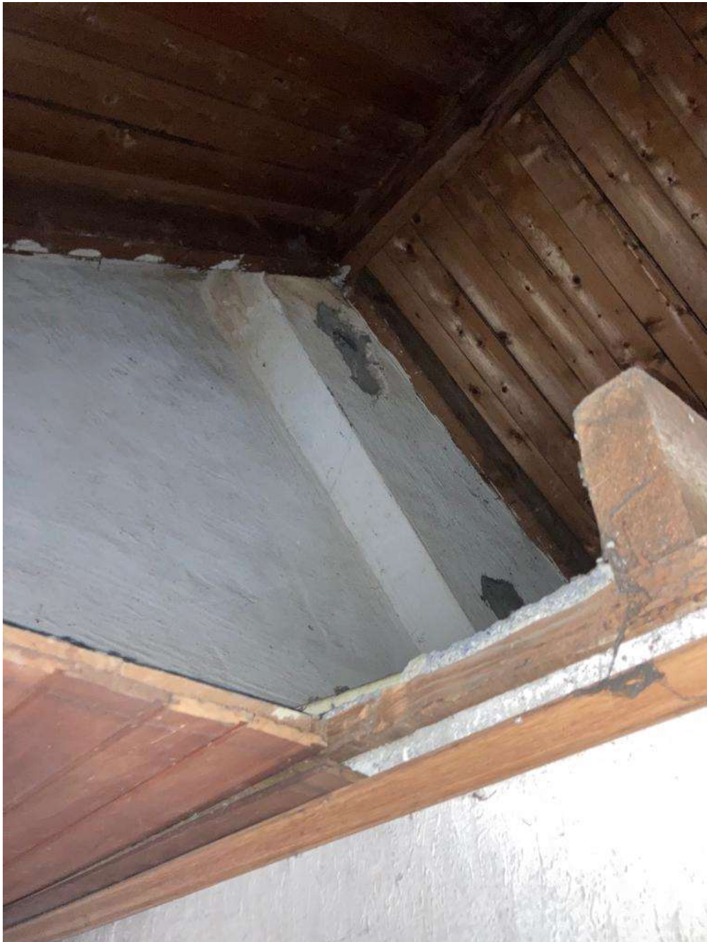
• Afbeelding 13: Onderzijde dak en vochtplekken in pleisterwerk
