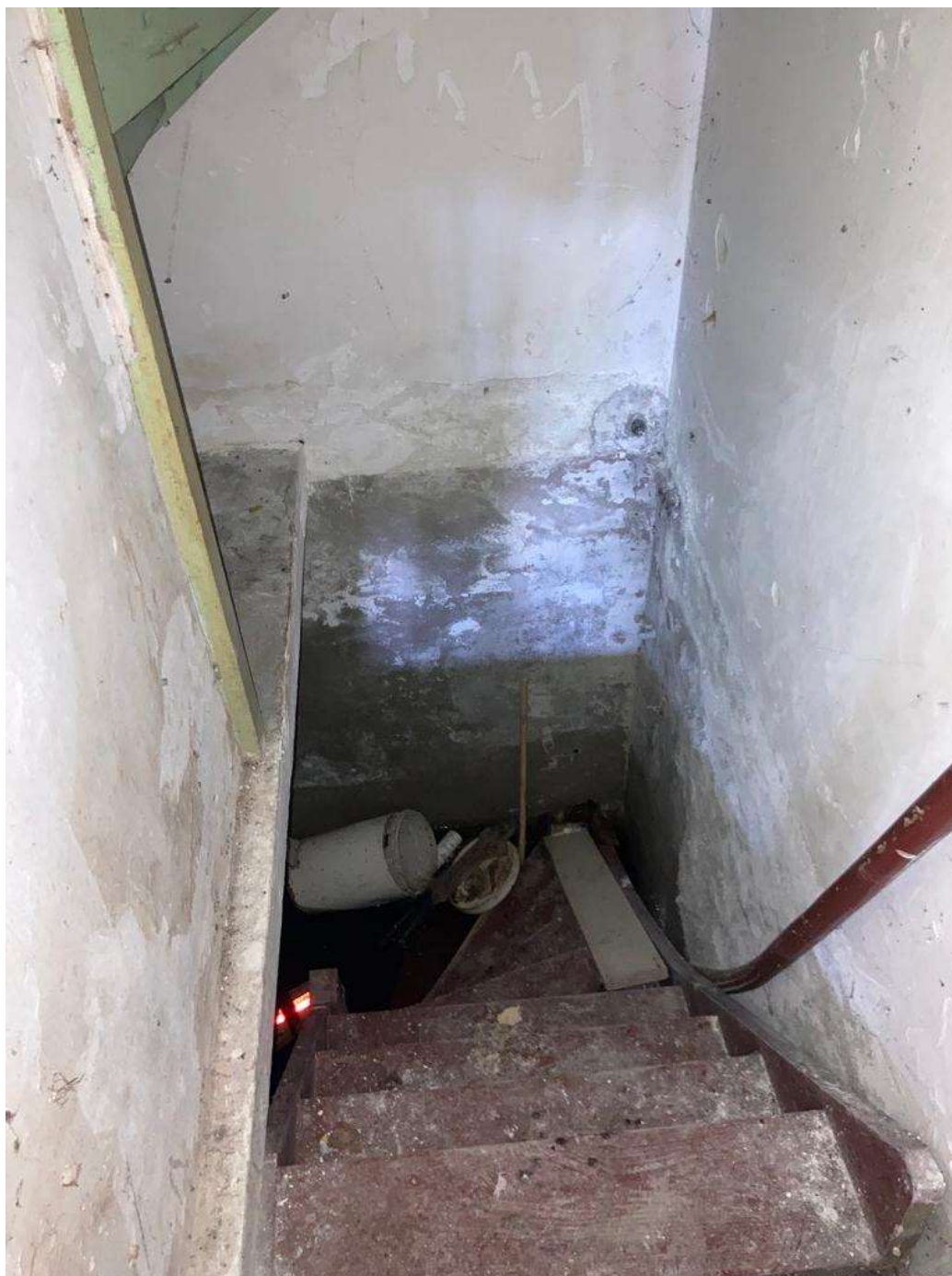
• Afbeelding 15: trap naar de kelder, veel vochtplekken op de muur
