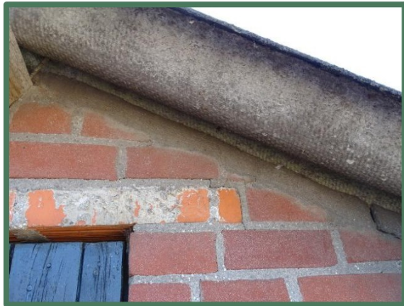
Foto 13: Dakranden gesloten met cement
