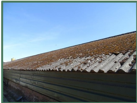
Foto 3: Overzicht golfplaten dak stal 3
