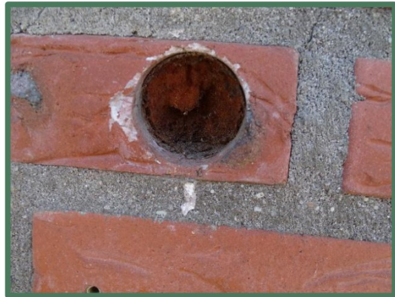
Foto 14: Oude openingen afgesloten met verweerd purschuim
