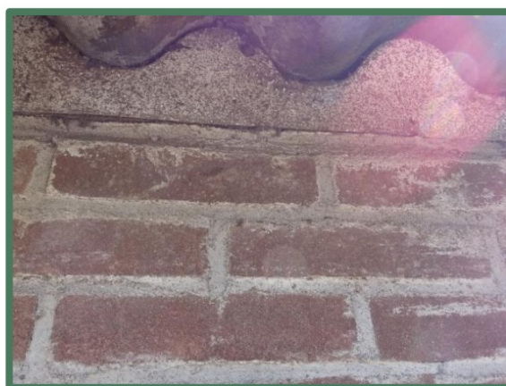
Foto 6: Vogelschroot onder dakplaten
