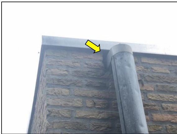
Figuur 15. Spleet in muur, mogelijk geschikt als verblijfplaats voor gierzwaluw.
