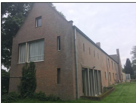
Figuur 13. Het voormalige klooster beschikt over dakgoten die mogelijk toegang geven tot ruimte onder de dakpannen.
