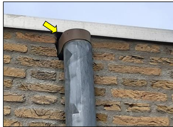
Figuur 16. Spleet in muur, mogelijk geschikt als verblijfplaats voor gierzwaluw.
