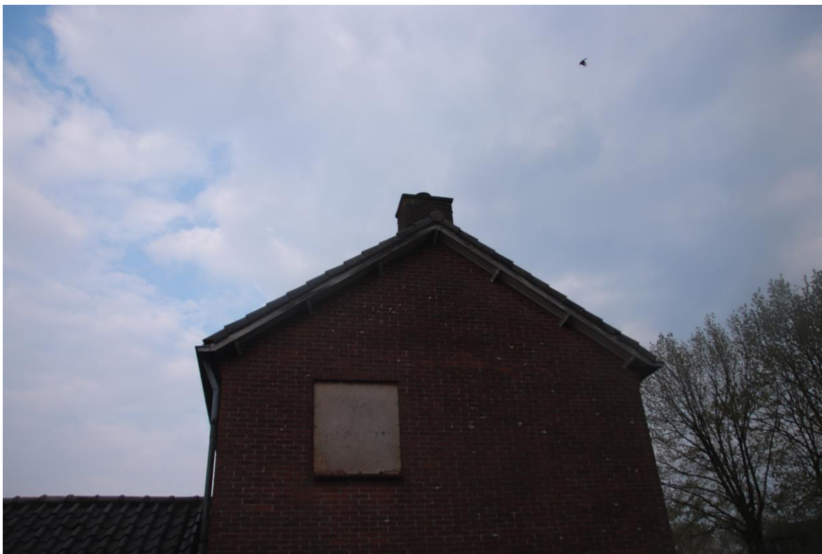
Foto 1: De voormalige woning is sterk onderkomen, delen van de dakpannen zijn eraf en de delen van de dakconstructie zijn in verrotte toestand.
