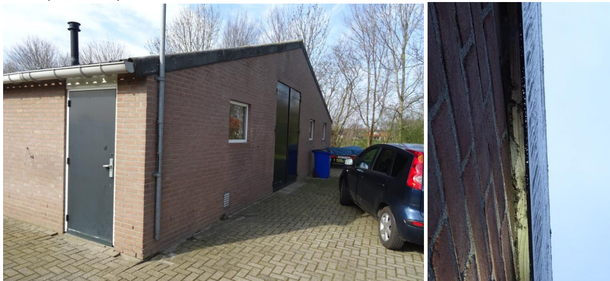
Afbeelding 7 en 8: Boeiboord van de onderzijde afgesloten. Bron: R.J.L. Bijvelds Datum: 29-01-2021
