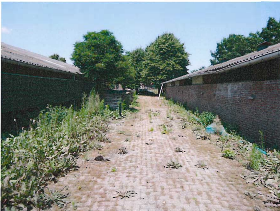
Foto 5: asbestverdachte golfplaten op de daken en klinkerverharding tussen de twee legstallen (gezien vanuit het zuidoosten, 18 juli 2013)
