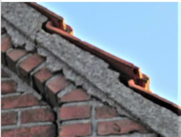
losgetrokken dakpannen gevel no. 2 (foto 2021)
