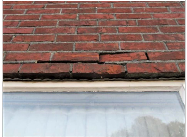
bakstenen beschadigd en gescheurd gevel no. 2 (foto 2021)
