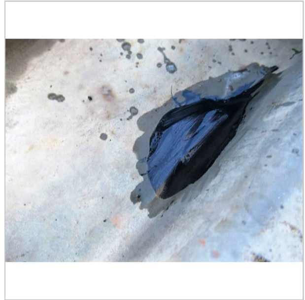
lekkage tijdelijk dichtgekit goot no. 1 (foto 2021)
