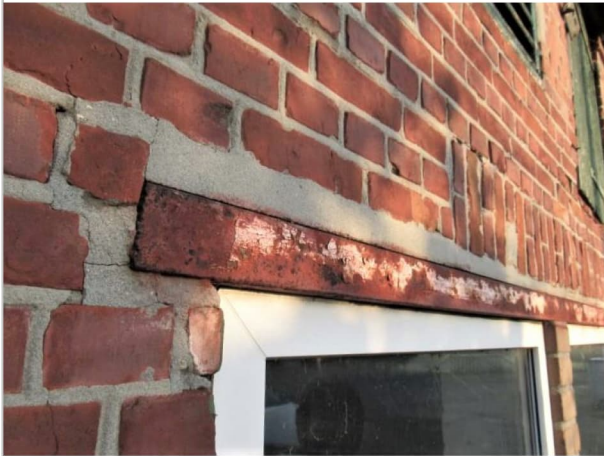
roestige stalen latei gevel no. 1 (foto 2021)
