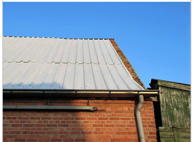
gevel no. 8 niet afgedekt (foto 2021)
