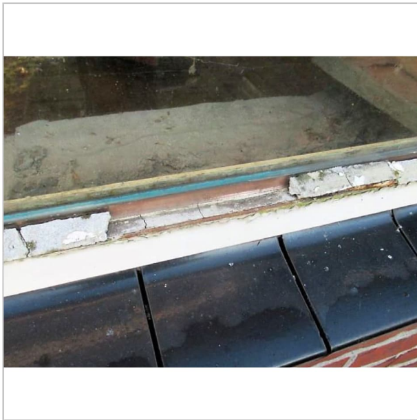
voegwerk weggevallen gevel no. 1 (foto 2021)
