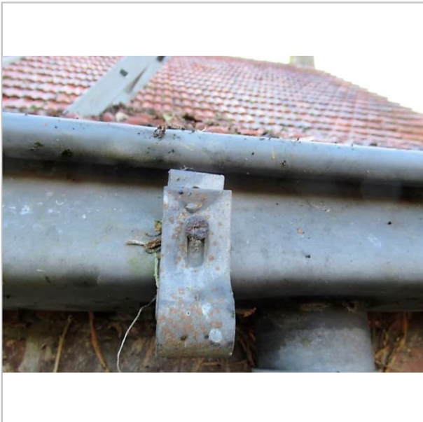
gootbeugels losgekomen goot no. 2 (foto 2021)
