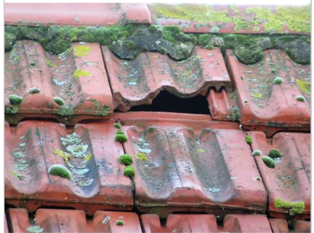
dakpan onder de nok stuk dak no. 4 (foto 2021)
