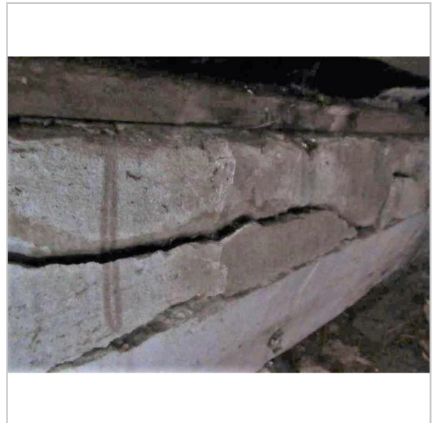
flinke scheurvorming gevel no. 1 (foto 2021)
