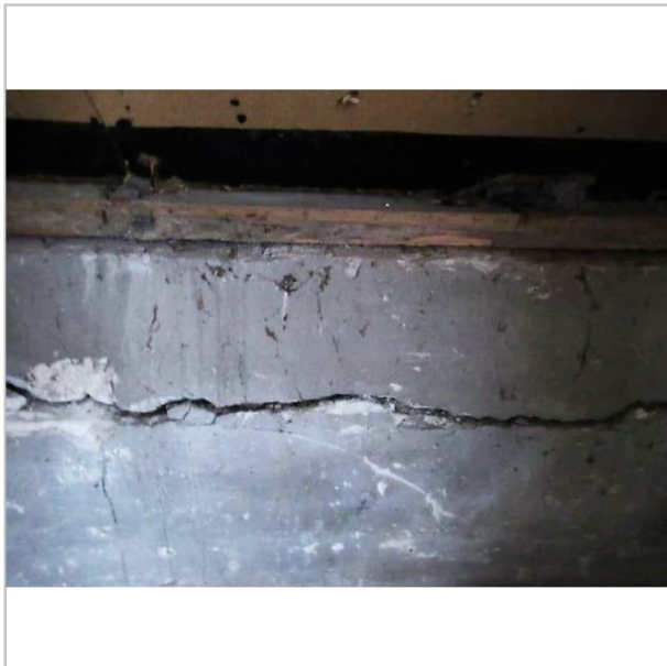
horizontaal gescheurd door de druk van het dak gevel no. 1 (foto 2021)
