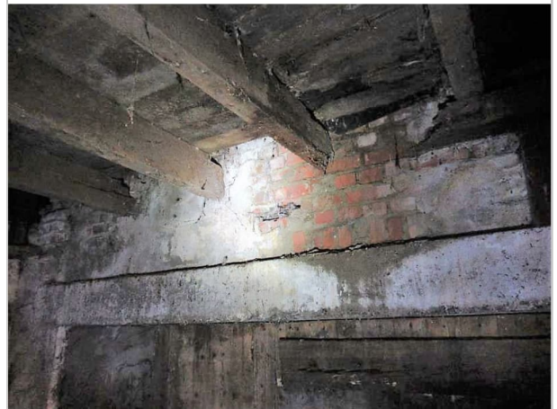
onderslagbalk geheel weggerot gevel no. 8, onder dak no. 5 (foto 2021)
