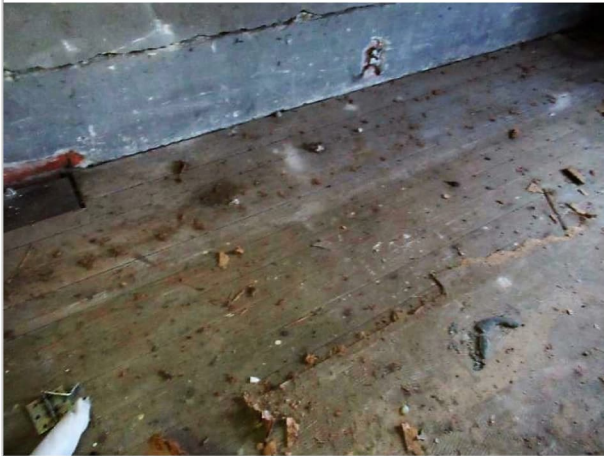
houtworm in de vloer verdieping woongedeelte (foto 2021)
