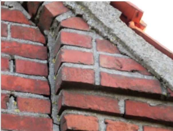
gescheurd buitenmetselwerk hoek gevel no. 1 en 2 (foto 2021)
