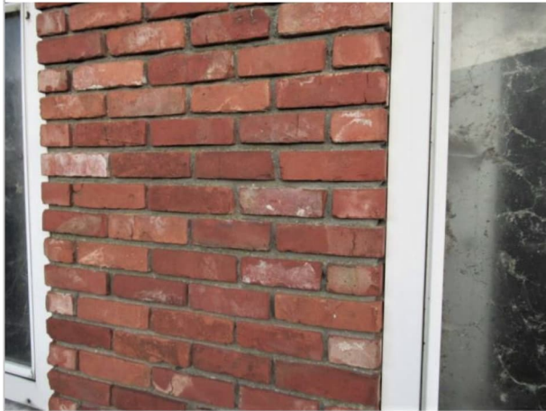
deels niet gevoegd gevel no. 1 (foto 2021)
