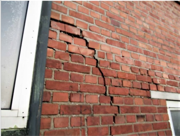
flinke scheurvorming gevel no. 1 (foto 2021)
