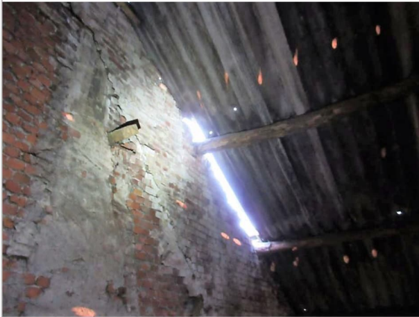
damwand dakplaten op dak no. 3 niet doorgelegd op gevel no. 8 (foto 2021)
