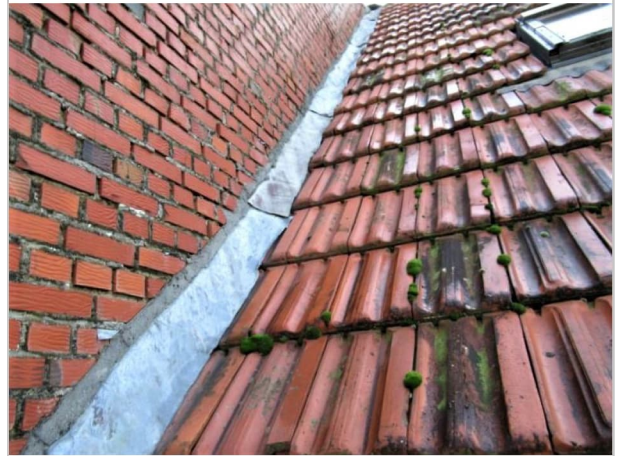
flink verweerd voegwerk gevel no. 6 (foto 2021)
