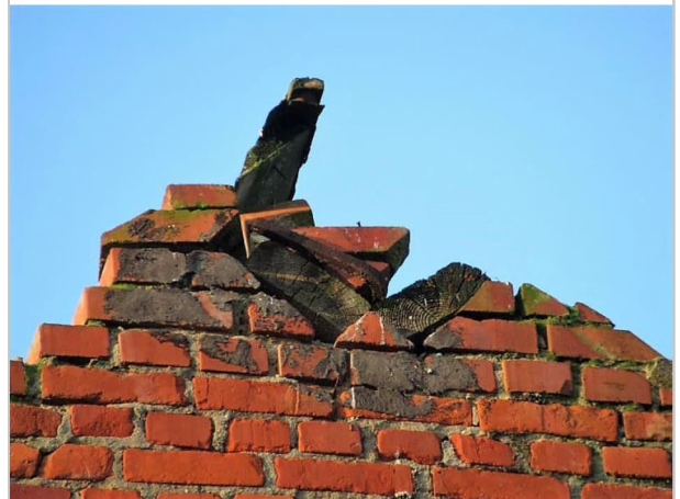
losliggende bakstenen gevel no. 8 (foto 2021)
