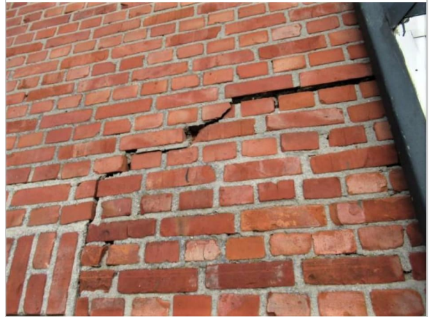
flinke scheurvorming gevel no. 1 (foto 2021)
