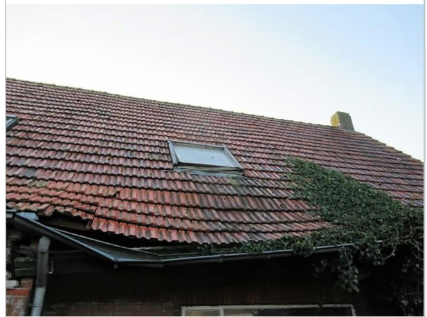
balk flink afgezaakt gevel no. 5 (foto 2021)
