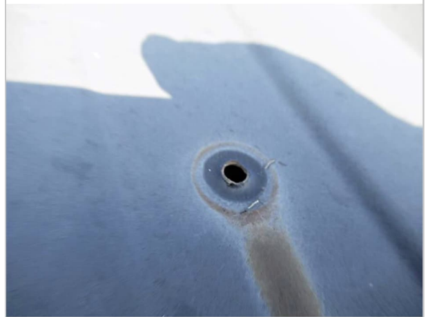
veel gaten in de damwand dakplaten dak no. 2 (foto 2021)
