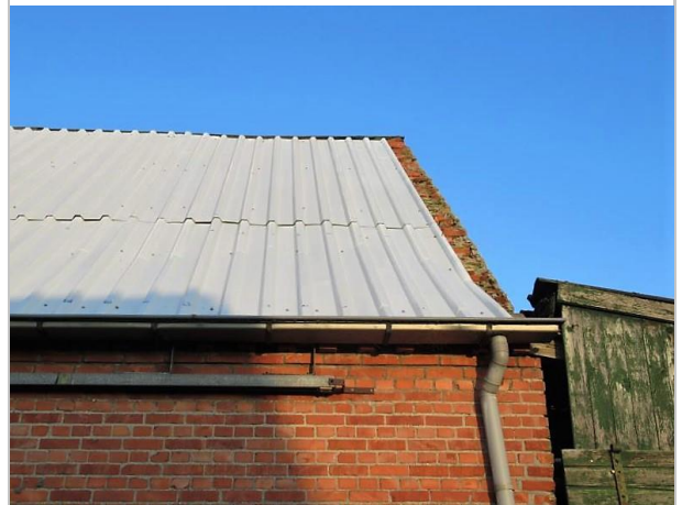
gevel no. 8 niet afgedekt (foto 2021)
