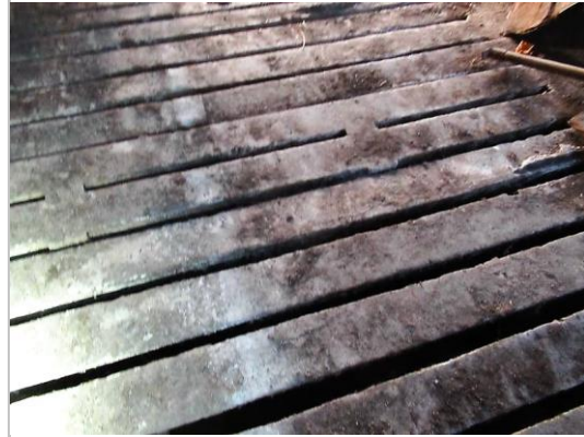
betonnen stalroosters (foto 2021)
