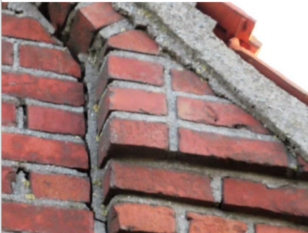
gescheurd buitenmetselwerk hoek gevel no. 1 en 2 (foto 2021)
