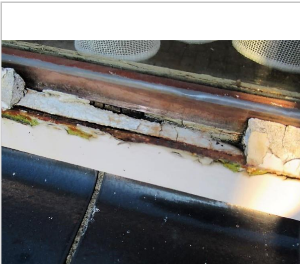
stalen kozijnen flink roestig onder het stopverf gevel no. 1 (foto 2021)
