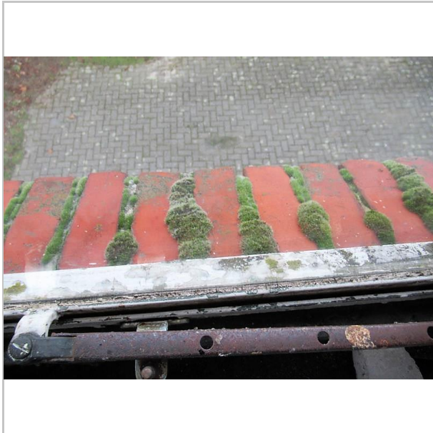
glaskit weggevallen gevel no. 2 (foto 2021)
