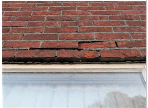
bakstenen beschadigd en gescheurd gevel no. 2 (foto 2021)
