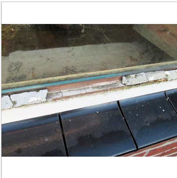
stopverf weggevallen gevel no. 1 (foto 2021)
