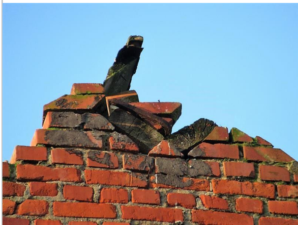
dakbedekking loopt niet door over de gevel gevel no. 8 (foto 2021)
