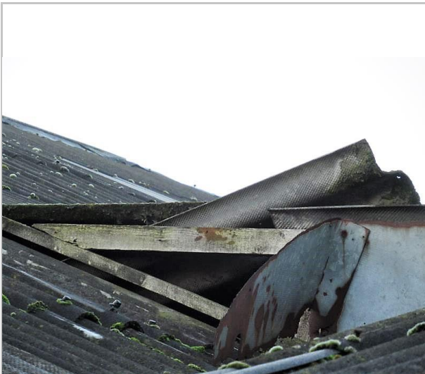
zijwang geheel stuk dak no. 5 (foto 2021)
