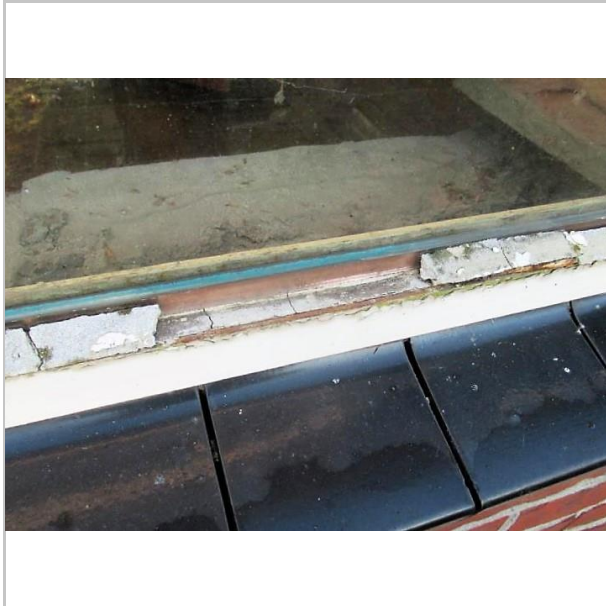
voegwerk weggevallen gevel no. 1 (foto 2021)
