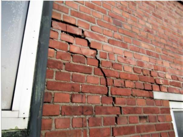
flinke scheurvorming gevel no. 1 (foto 2021)
