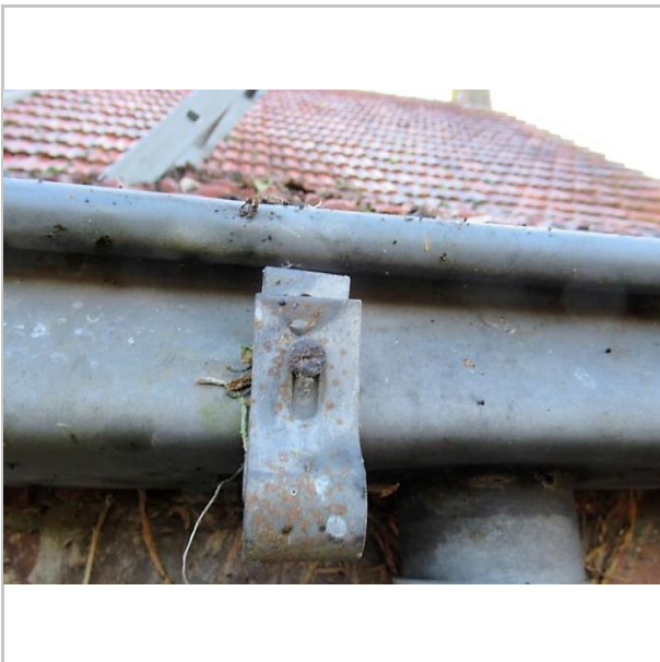
gootbeugels losgekomen goot no. 2 (foto 2021)
