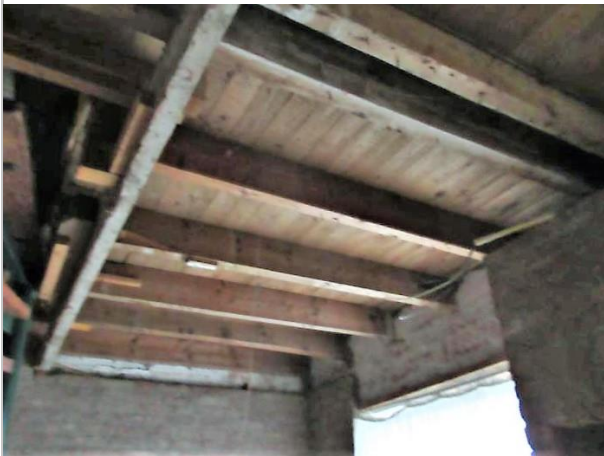
geen plafond aanwezig (foto 2021)
