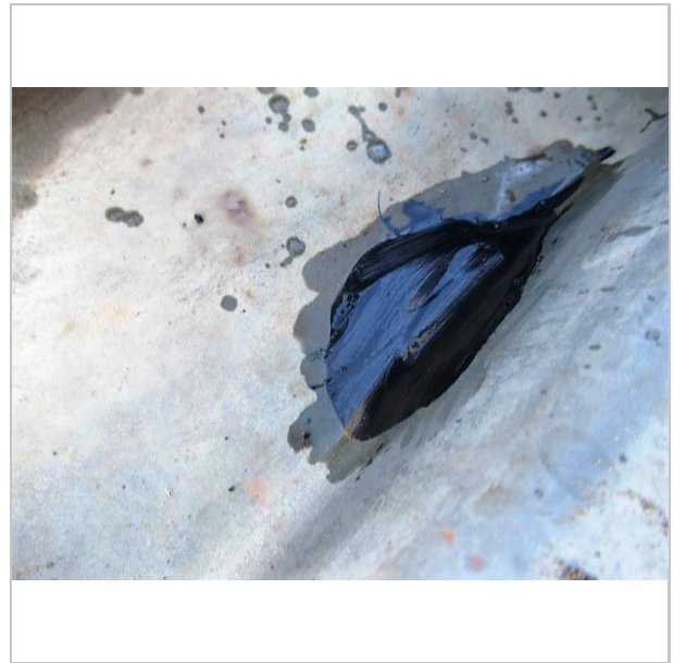
lekkage tijdelijk dichtgekit goot no. 1 (foto 2021)
