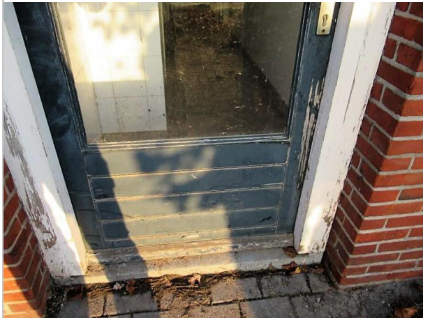
buitenschilderwerk slecht gevel no. 1, voordeur (foto 2021)
