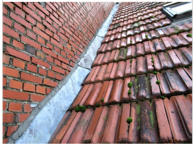
flink verweerd voegwerk gevel no. 6 (foto 2021)
