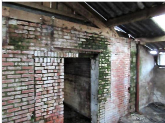
lekkages in het stalgedeelte (foto 2021)
