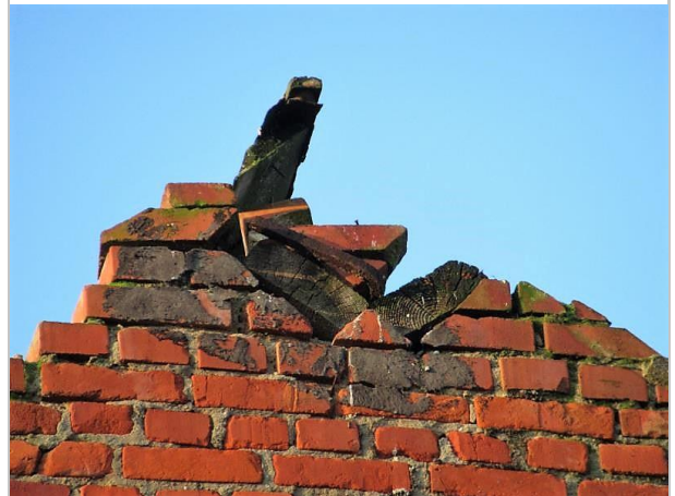
losliggende bakstenen gevel no. 8 (foto 2021)
