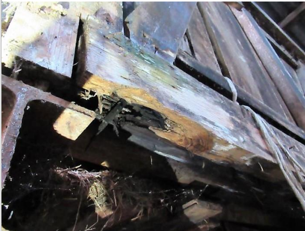
houten balk flink ingerot dak no. 5, tegen gevel no. 7 (foto 2021)
