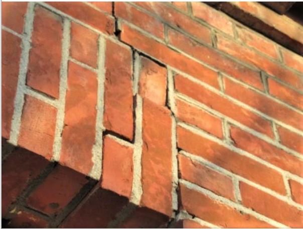
zetscheur gevel no. 1, boven de voordeur (foto 2021)
