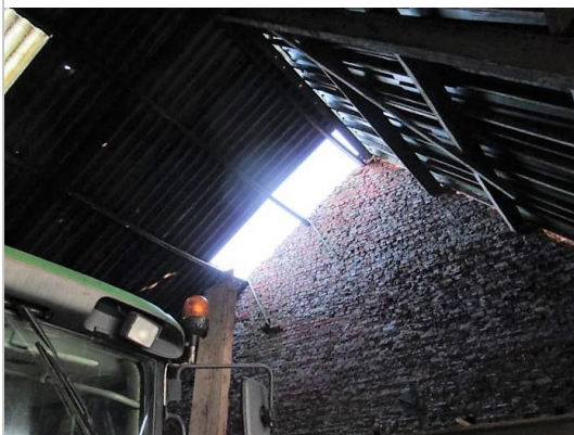
dak no. 5 enkele golfplaten weggevallen (foto 2021)
