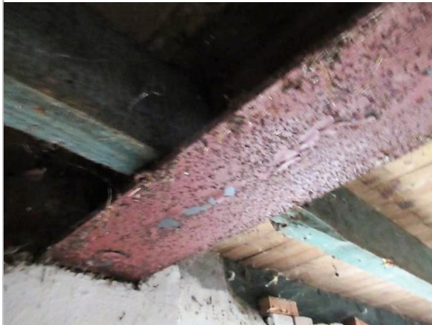
roestige vloerbalk (foto 2021)
