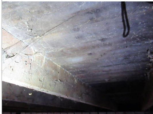
houtworm in de vloerbalken in het stalgedeelte (foto 2021)
