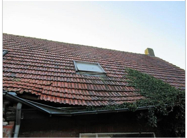
balk flink afgezaakt gevel no. 5 (foto 2021)
