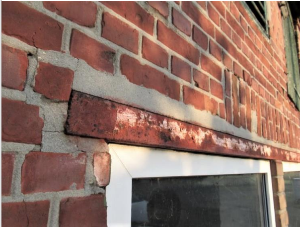
roestige stalen latei gevel no. 1 (foto 2021)
