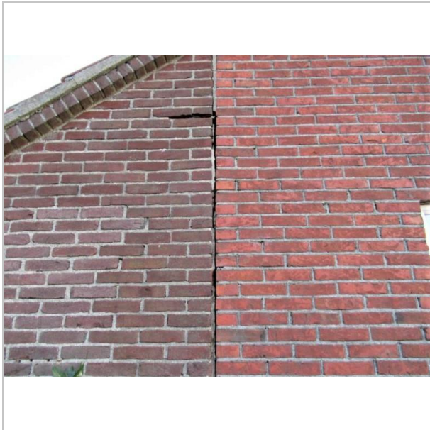
zetscheur en opgeroest ijzerwerk gevel no. 2 (foto 2021)
