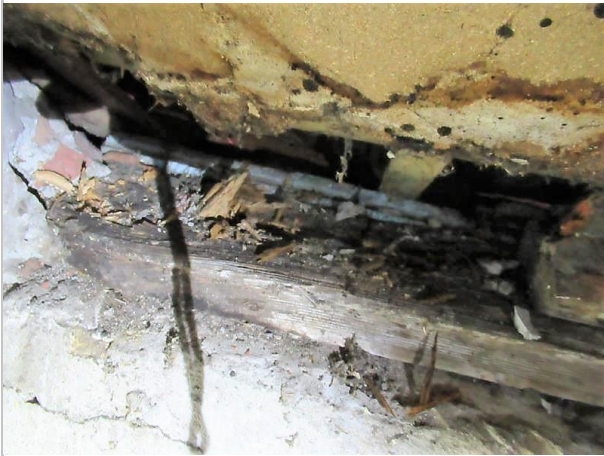
rotte muurplaat tegen gevel no. 2 onder dak no. 4 (foto 2021)
