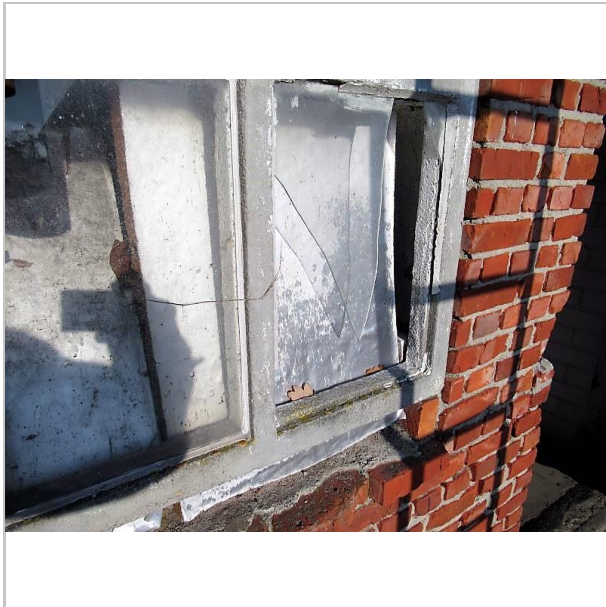
ruit gescheurd gevel no. 1 (foto 2021)
