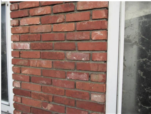
deels niet gevoegd gevel no. 1 (foto 2021)
