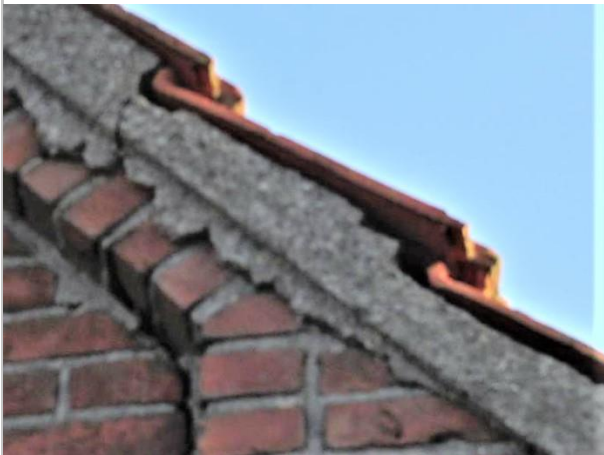
losgetrokken dakpannen gevel no. 2 (foto 2021)
