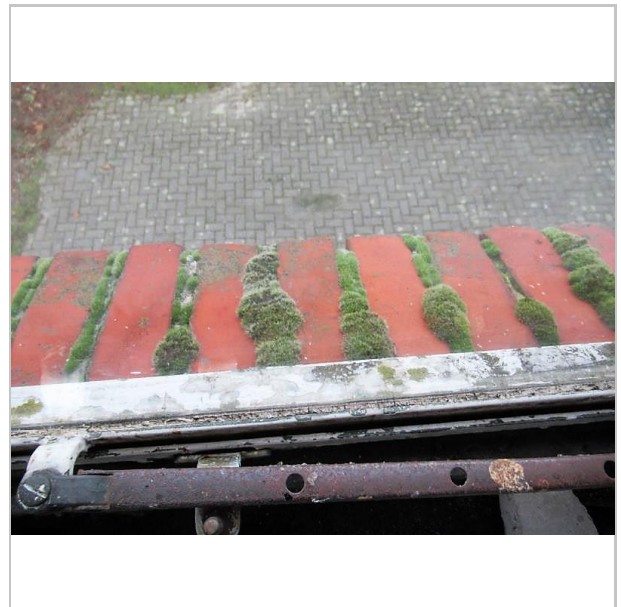
stalen buitenramen roestig gevel no. 2 (foto 2021)
