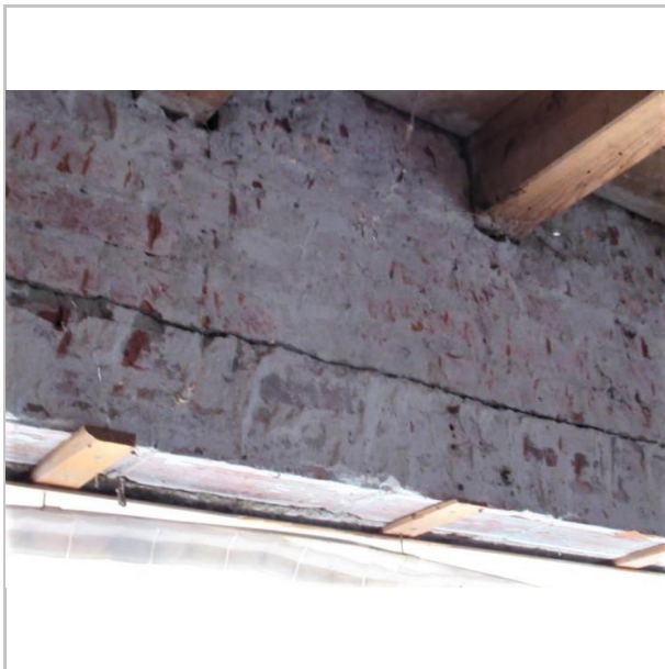
latei losgescheurd gevel no. 1, woongedeelte (foto 2021)
