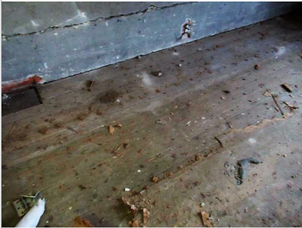
houtworm in de vloer verdieping woongedeelte (foto 2021)
