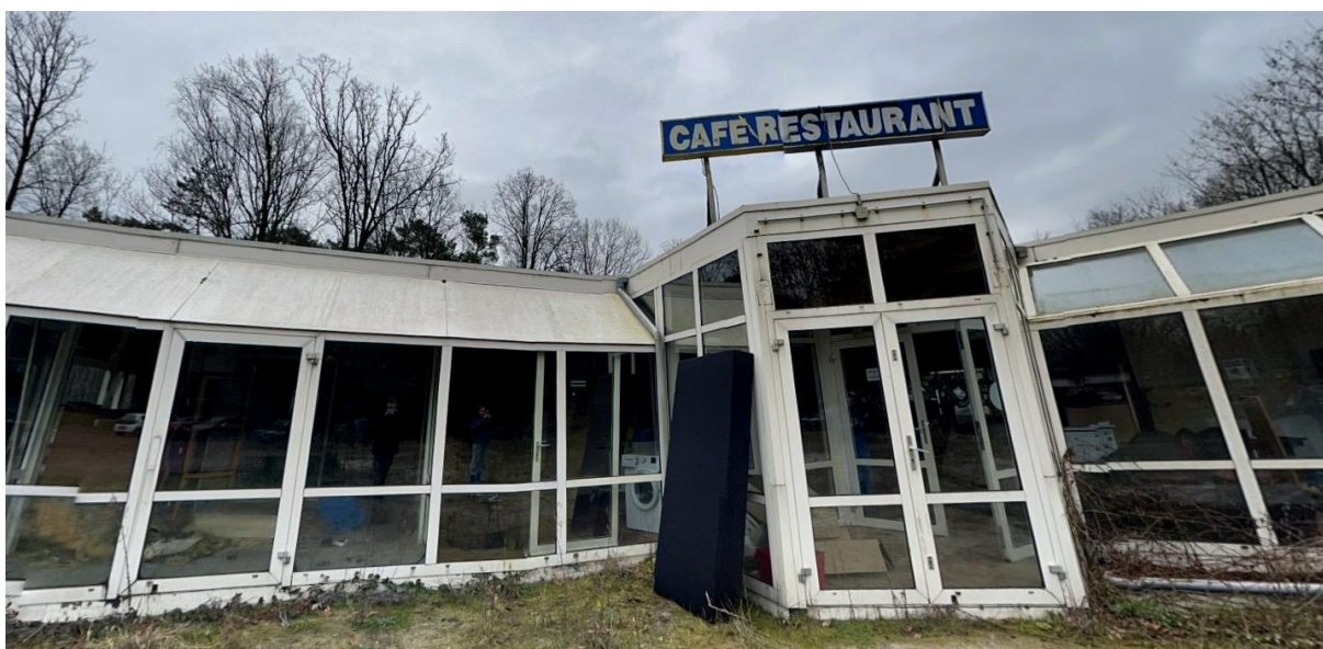
Figuur 4.7 Bestaand winkelgebouw in zeer vervallen staat (bron: Google Streetview, februari 2023)
