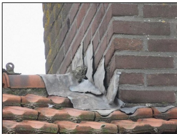
Foto 6. Niet aansluitende loodslabben
