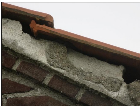
Foto 5. Openingen tussen de dakpannen en de dakrand
