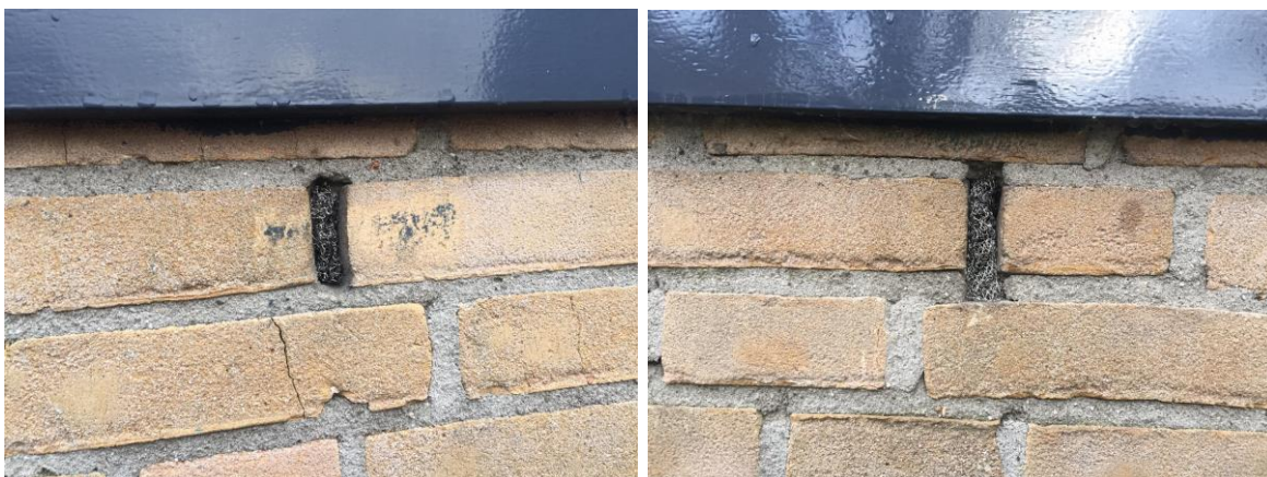
Afbeelding 7 en 8Ja: De open stootvoegen naar de spouw zijn d.m.v. weringsgaas afgesloten. De aanwezigheid van vleermuizen is dus uitgesloten. Bron: Rik Bijvelds Datum: 01-12-2020
