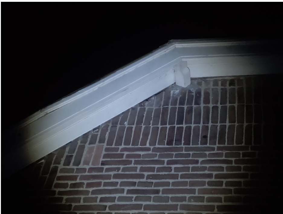
Op enkele plaatsen zijn kieren aanwezig die geschikt zijn voor vleermuizen, zoals hier onder de dakrand van het woonhuis. Foto: K.C. Fokker | Ecoresult B.V.
