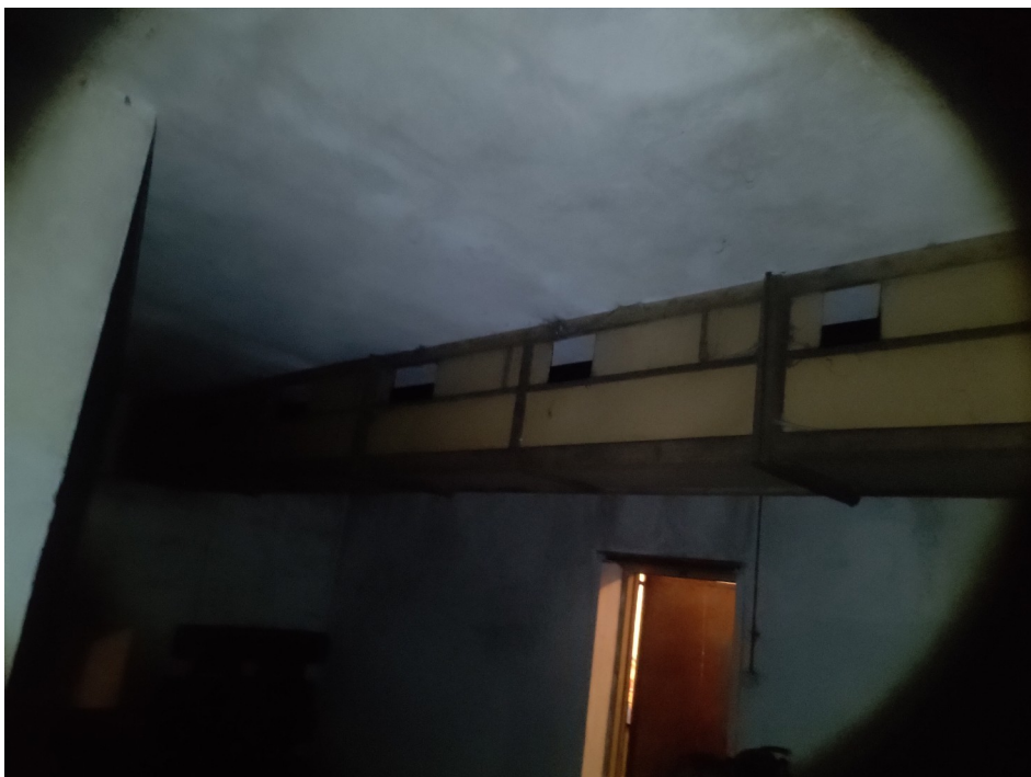
De ventilatiepijpen in de fruitopslag staan in direct verbinding met de open lucht. Omdat platen ontbreken is de opslag toegankelijk van buitenaf door uilen en vleermuizen. Foto: K.C. Fokker | Ecoresult B.V.
