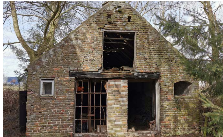
Het oude bakhuisje/schop op het erf is sterk vervallen
