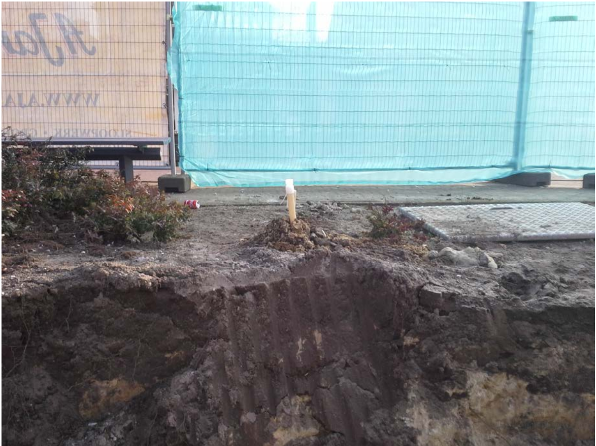
Foto van de geplaatste peilbuis – 10 maart 2016
