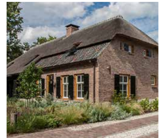
Pannen ter plaatse van het woonhuis
