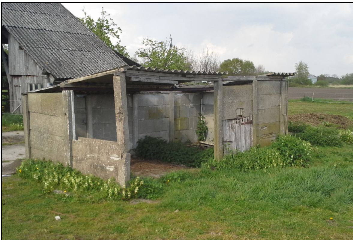
foto 3 : schuurtje met kapot asbestdak en asbest in bebouwing
