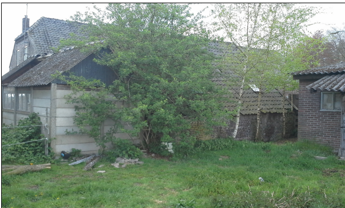
foto 4 diverse beschadigde asbestdaken
