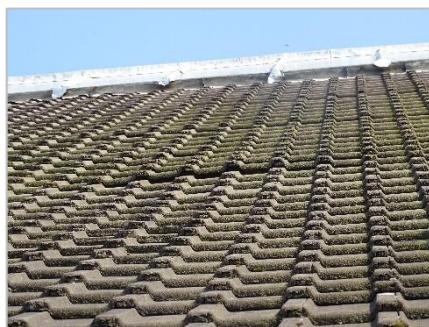
Foto 15: Dakbedekking met openingen tussen pannen.
