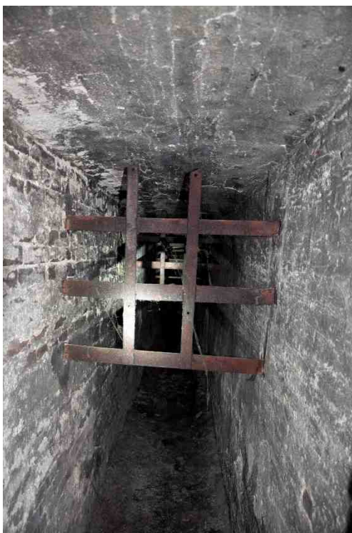
33 ventilatiekanaal onder de oven
