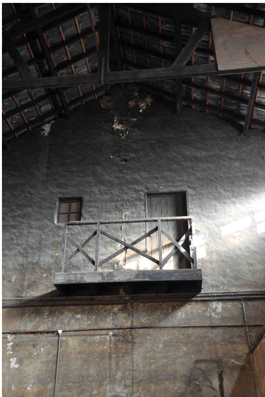
37 de toegang tot de bovenwoning met bordes. De trap ontbreekt momenteel
