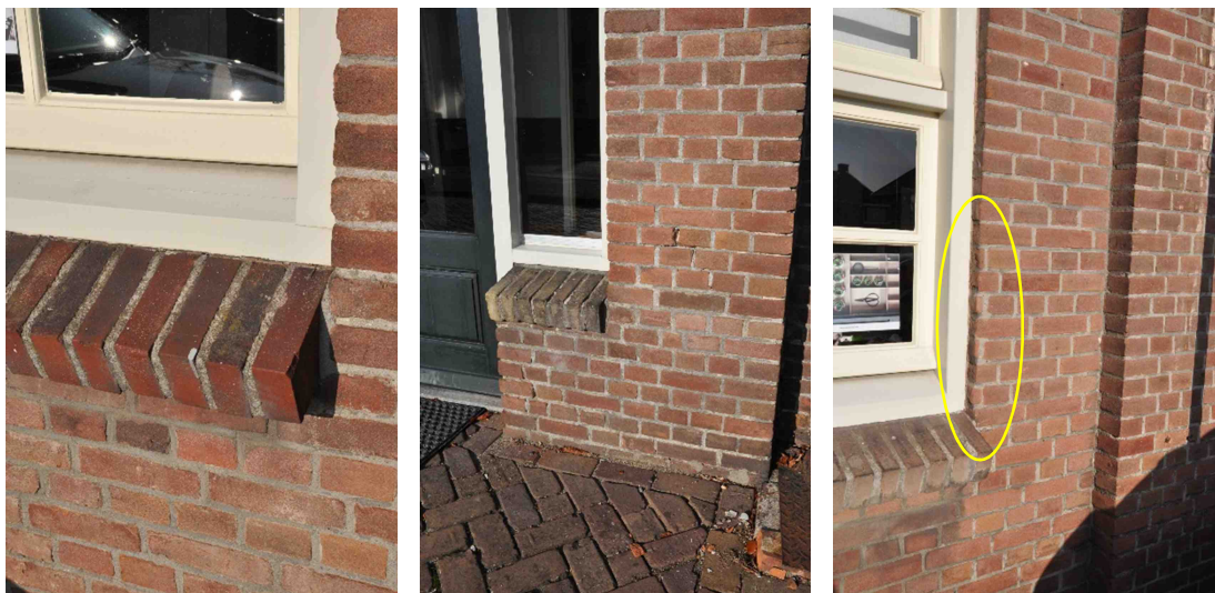
21 – 23 verschillende bouwsporen in het metselwerk van de voorbouw. v.l.n.r.; 21) afwijkende strengperssteen van de afzaat van het later aangebrachte rechter venster. 22) afwijkende steen in de plint aan weerszijden van de centrale toegangspui als gevolg van de later aangebrachte wijzigingen. 23) verzaagd metselverband als gevolg van het vergroten van de vensters naar de onderzijde.
