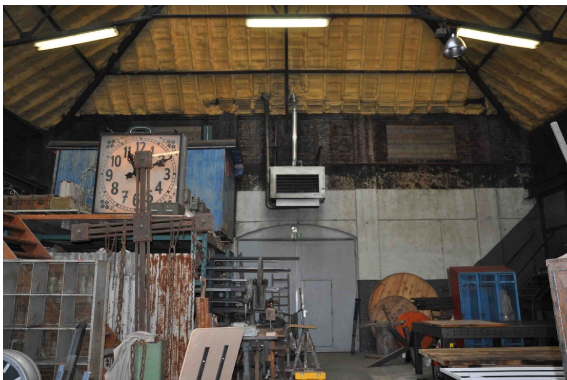
24 in de gehavende gevel aan de achterzijde zijn de bouwsporen van de oorspronkelijke situatie nog af te lezen. De vensters van de lichtbeuk zijn dichtgezet. Daaronder zijn de sporen van het voormalig binnenpleisterwerk nog afleesbaar.
