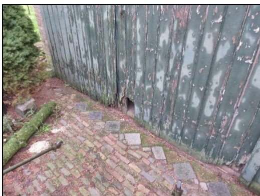
Foto 11. Mogelijke ingang voor marters bij noordingang van de varkenstallen
